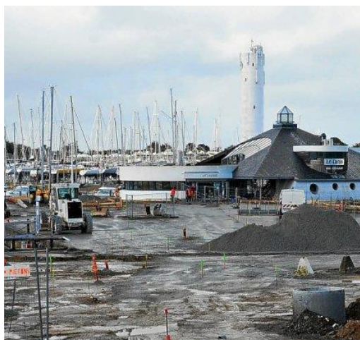
Les abords de la capitainerie du port du Crouesty en plein chantier.
